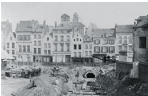
Tientallen huizen in de Bisschopsstraat verdwenen onder de sloophamer bij de overwelving van de Zenne (Anspachlaan). Centraal op de achtergrond staat een toren, kort voor haar afbraak. Deze toren werd soms voor de Mechelsepoort gehouden.
