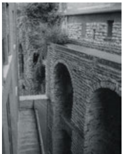
Recent zicht van de walmuur in de Wildewoudstraat 17-21. De steunbogen van de weergang en de borstwering met kantelen zijn duidelijk zichtbaar.
