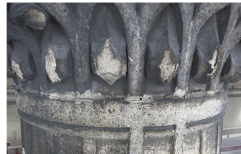
Schade aan een kapiteel in Euvillesteen, 2013*.
