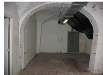
Afb. 17 Randkolommen en grondkeermuur uit het lood en geknikte bogen in de kelder (© T.ar.S. bvba).
