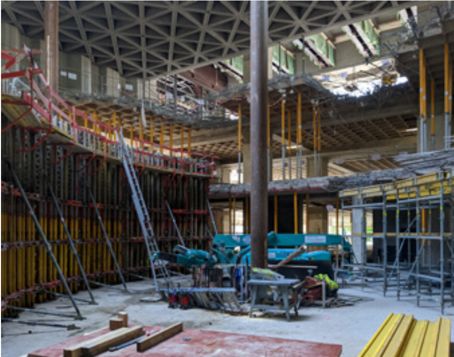
AFB. 6B De nieuwe circulaire circulatie in aanbouw in het centrum van het gebouw (J.-M. Basyn, 2022 © urban.brussels).
