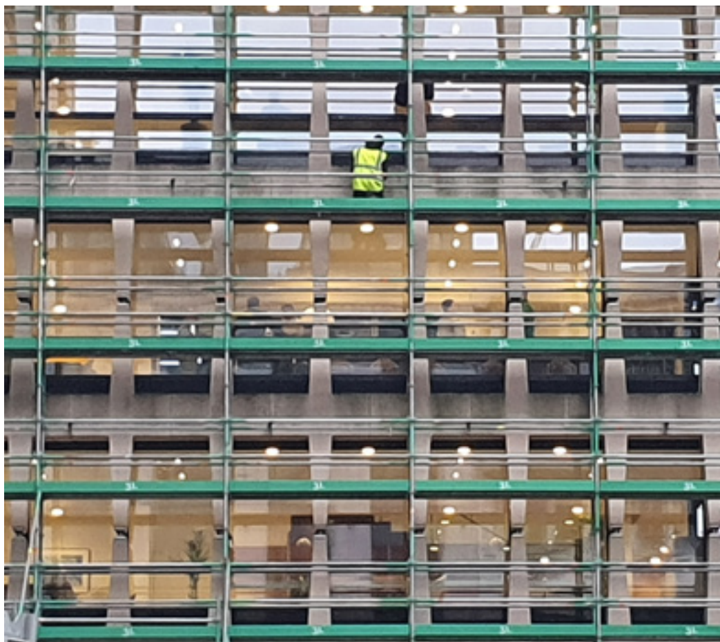
AFB. 7B ING Marnixlaan in Brussel. Marnix I arch. Gordon Bunschraft (S.O.M.) 1960, Marnix II en III arch. S.O.M. en Philippe Samyn 1988-1992. Werkzaamheden aan de gevels van Marnix II en III (J.-M. Basy, 2024 © urban.brussels).
