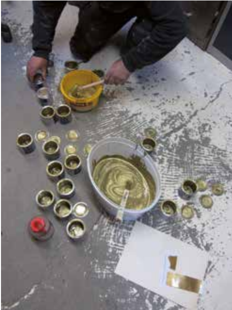
Het mengen van de kleuren bij Rova sprl, de onderneming die de verf aanbracht met de verfspuit (foto van de auteur).
