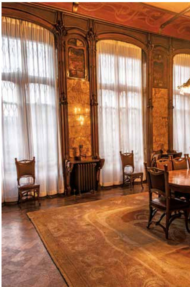
De radiatoren in de eetkamer waarbij de aangevoerde lucht met de stralingswarmte wordt vermengd (A. de Ville de Goyet © urban.brussels).
