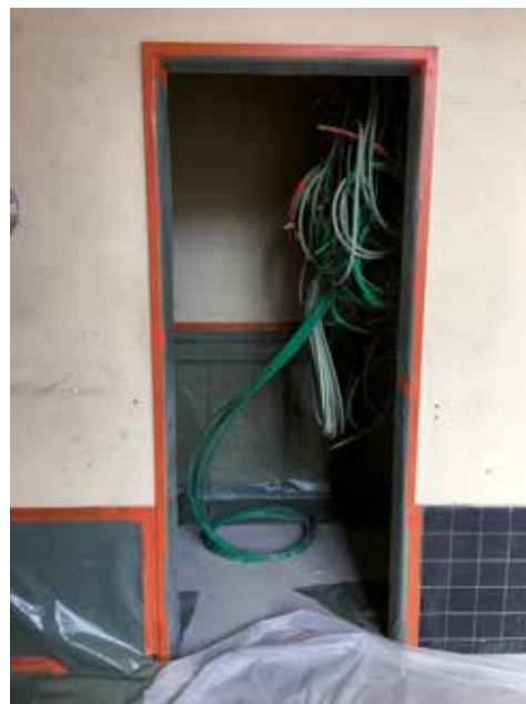
AFB. 1 Gemeentehuis Vorst – gebruik van bestaande technische ruimtes voor het bundelen van nieuwe leidingen (© Origin, 2019).
