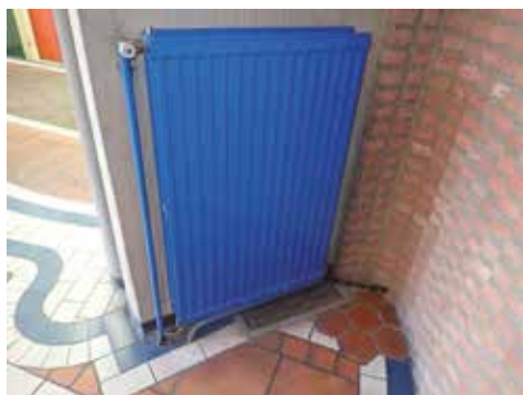
AFB. 11 Bestaande radiator op de begane grond (© Origin, 2018).
