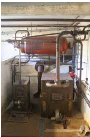
AFB. 26 De twee stookolieketels van Villa Cavrois in Croix, respectievelijk bestemd voor verwarming en voor de productie van sanitair warm water. Architect Robert Mallet-Stevens, 1932 (foto van de auteur).
