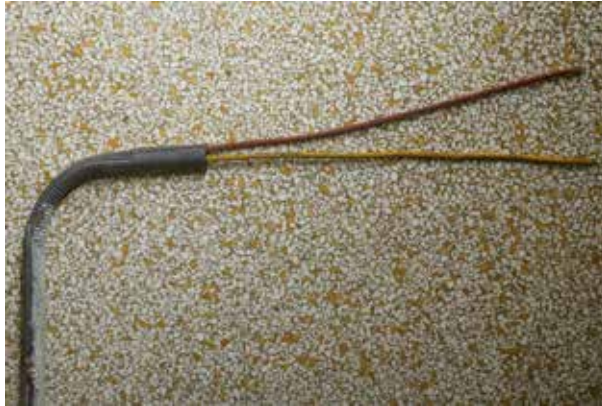
AFB. 16 Elektriciteitsdraden in metalen leidingen. Standaardinstallatie tijdens het interbellum. Particuliere woning, Brussel, 1926 (foto van de auteur).
