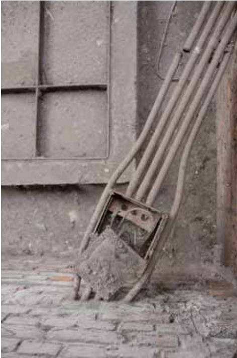
AFB. 31 Overblijfselen van oorspronkelijke elektrische installaties worden schaars, maar soms treffen we er nog voorbeelden van aan op zolders. School van de Groendreef, Masuistraat te Brussel. Architect Henri Jacobs, 1930 (foto van de auteur).
