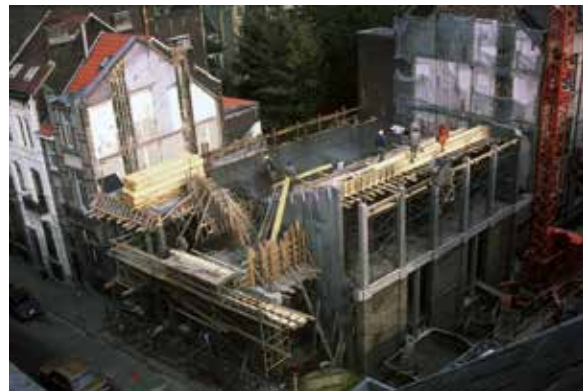
Afb. 15 De aula's op het tweede niveau in aanbouw, panoramisch zicht, 1989 (© AUCL, Faculté LOCI/Fonds Jean Cosse).
