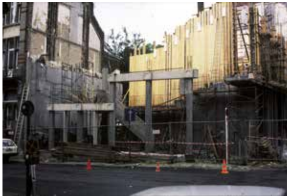
Afb. 12 De kolommen aan de straatkant van de benedenverdieping in aanbouw, 1988-1989 (© AUCL, Faculté LOCI/Fonds Jean Cosse).
