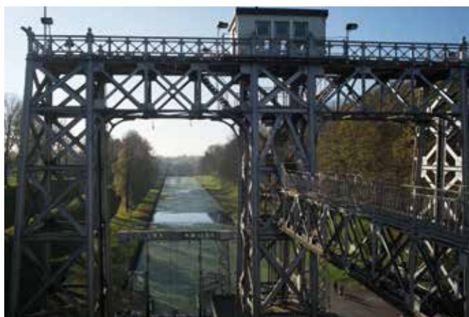
Dominique BAUDUIN Sluis/Scheepslift nr. 2 van het Centrumkanaal, Houdeng-Goegnies
