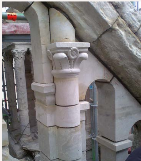
Herstellingen van de stenen ornamenten en consolidatie van de bestaande toestand, zelfs indien deze een zekere verwerking vertoonde. De centrale beeldhouwde elementen en kapitelen kregen meer aandacht dan verder naar achter of zijdelings gelegen elementen [© GOB].
