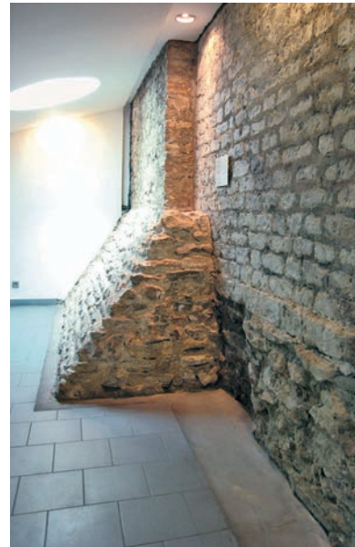
Afb. 12b De funderingen van de middeleeuwse poort en die van Beyaerts gevel zijn te zien in de nieuwe technische ruimte, die ook de sanitaire voorzieningen bevat (S. Modrie, 2009 © MBHG).
