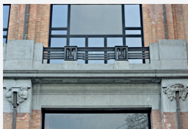
Afb. 1.6. Ijzeren ramen en borstweringen, koperen goten, hardstenen ( petit granit ) dorpels, lateien en decoratief beeldhouwwerk.
