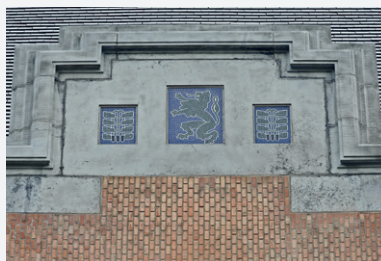
Afb. 1.7. Hardstenen ( petit granit ) omlijsting, mozaïek met Venetiaans glas ( smalttype ), parement van baksteen, dakbekleding met geglazuurde pannen.
