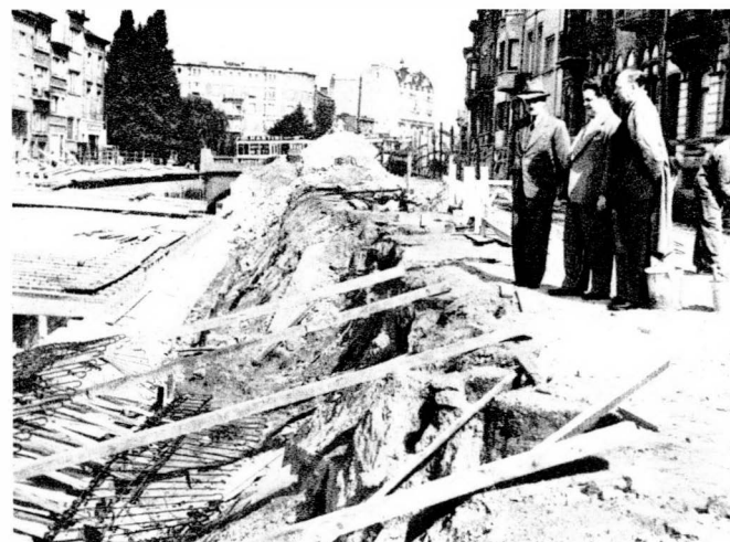
Ultime travaux pour le voûtement des voies sur le territoire de Saint-Josse-ten-Noode: le boulevard des Quatre Journées trouve enfin la paix, à l'image du square A. Steurs (visible à l'arrière plan) 20 ans plus tôt. Photographie de 1952.
