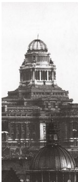
La structure d'acier du nouveau dôme pendant sa construction, d'après les plans de l'ingénieur A. Storrer.
