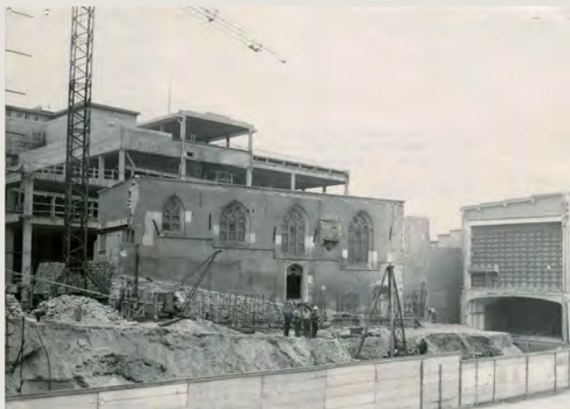
La chapelle Saint-Georges. En arrière-plan : le corps central de la bibliothèque en construction. Photo sans date. (© CRMS)
