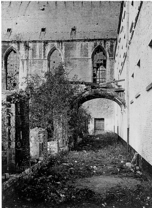
Le mur de l'aile du réfectoire démolie par les militaires.
