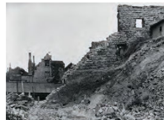
Tronçon de courtine au bas de la rue de Ruysbroeck, lors de sa démolition en 1953 pour la construction de la Bibliothèque Royale Albert I er .
