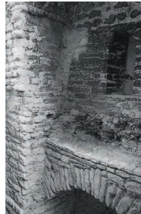
Détail de la courtine de la rue du Bois Sauvage : entre deux piliers, le mur écran supporté par l'arc de fondation est percé d'une meurtrière.
