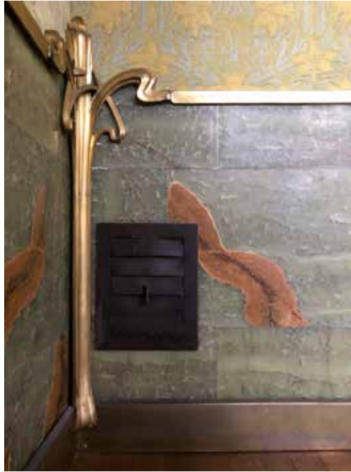
FIG. 10B Détail de la même grille de ventilation (© B. Van der Wee Architects, 2020).
