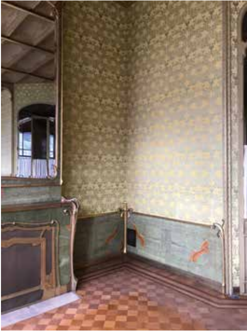
FIG. 10A Le salon côté rue : la grille de ventilation en laiton, refermable, par laquelle est amené l'air frais de la cave se situe dans le coin sous la plinthe en onyx (n° 2 dans la FIG. 9) (© B. Van der Wee Architects, 2020).
