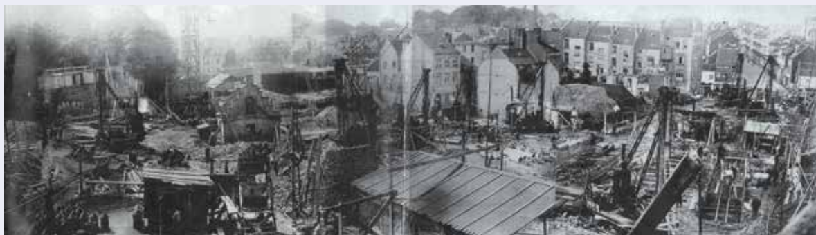
Le chantier du Résidence Palace, rue de la Loi à Bruxelles, photographié en 1923. 2.458 pieux Franki de 6 à 12 m de profondeur y furent moulés. Tirage argentique, 16 x 55 cm (© CIDEP).
