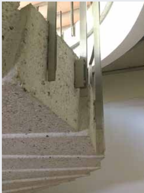
Fig. 8 et 9 Détails des marches de l'escalier en béton reliant le premier sous-sol et le rez-de-chaussée (Fig. 8 et Fig. 9, A. Totelin, 2018 © Urban.brussels).
