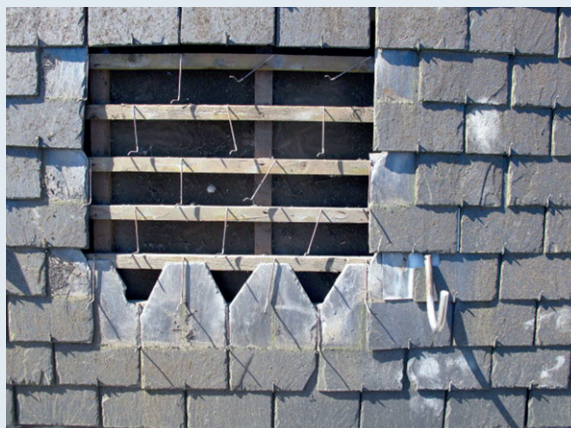
Fig. 5 État de la toiture avant travaux de restauration (© ARTER, 2013).
