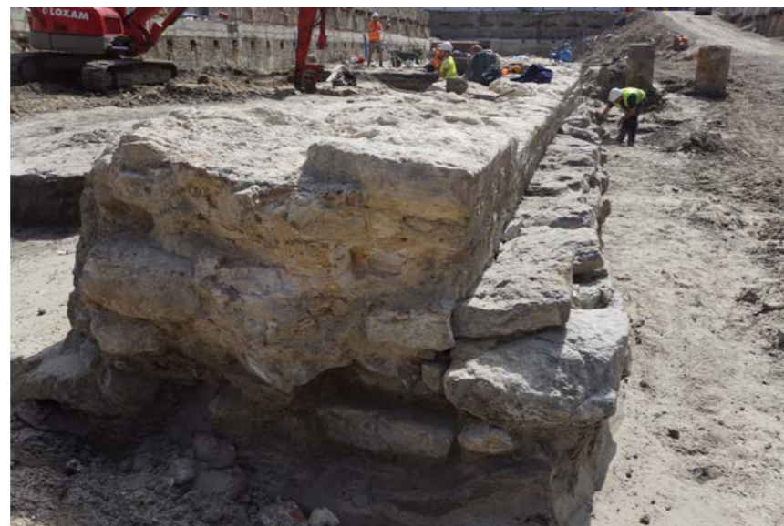
III. 48 : Glissement du mur qui se désolidarise de son ressaut de fondation (3.a) (© urban.brussels).
