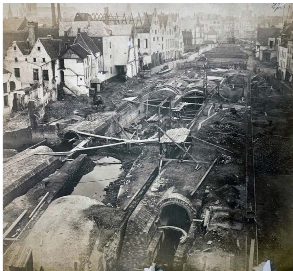
III. 104 : Chantier du voûtement de la Senne de la rue des Teinturiers à la rue de l'Évêque, juin 1870 (© KBR).
