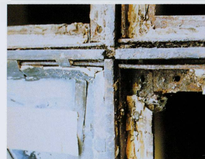
Corrosie bedreigt ook de bevestigingselementen en de metalen omlijstingen. Wat het meest voorkomt, is de veroudering van de loodstrips die vooral tot uiting komt in het verlies van hun mechanische weerstand. Door de inwerking van kooldioxide wordt het lood omgezet in loodcarbonaat waardoor het poreus wordt en makkelijk breekbaar. Men merkt ook de beschadiging van de metalen kaders, de barlotières, die met roest zijn bedekt.
