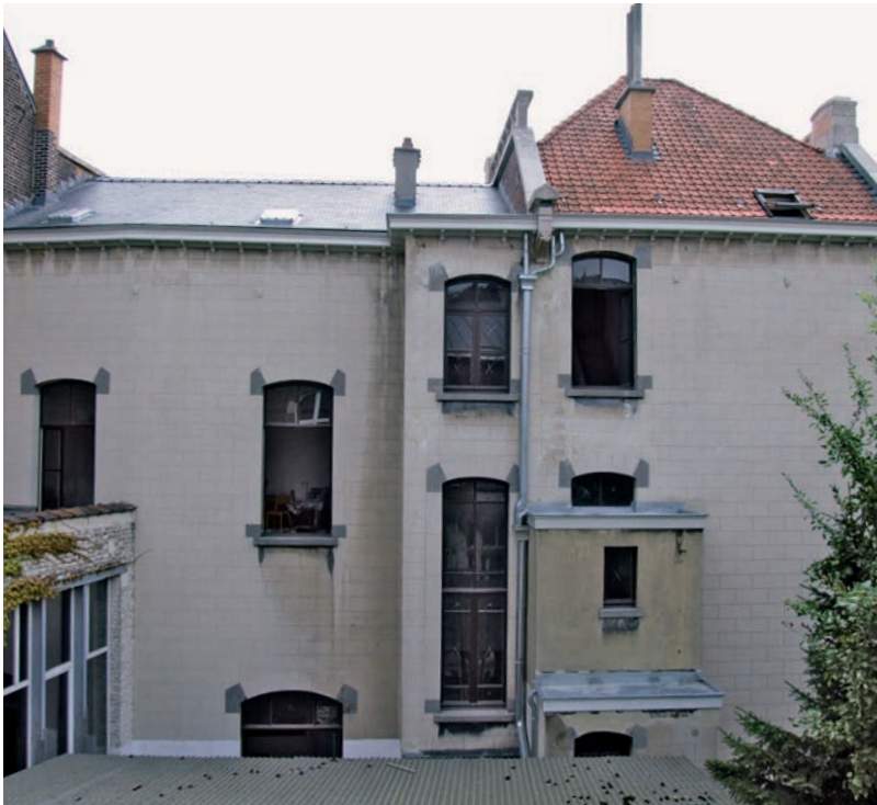
Fig. 15 Achtergevels: problemen bij de reiniging en reparatie van de steenimitatie.
